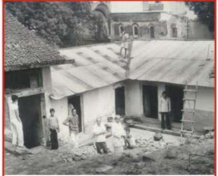
सन् 1971 में पुरानी मकानरूपी धर्मशाला का नवनिर्माण करने हेतु डिस्मेन्टल के समय निरीक्षण करते न्यास के अध्यक्ष स्व.श्री गोवर्द्धनलालजी मेहता, उपाध्यक्ष श्री मांगीलालजी शर्मा (पटेल), सचिव डॉ. रामरतनजी शर्मा
